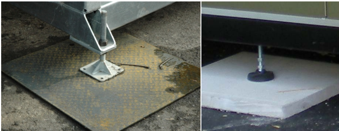
Figure 47: Pour supporter la masse un composteur sur de l'asphalte, on peut ajouter (a) des plaques d'acier ou (b) des insertions de béton sous les pattes pour répartir la charge. Ceci représente une alternative économique à la dalle de béton armé (photos Louise Hénault-Ethier).
