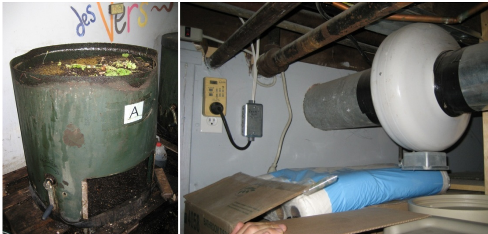
Figure 135: (a) Bacs de type Wig Wams utilisés au Santropol et (b) équipement et contrôle de la ventilation pour la pièce dédiée au compostage située au sous-sol de la popote roulante (photos Louise Hénault-Ethier).
