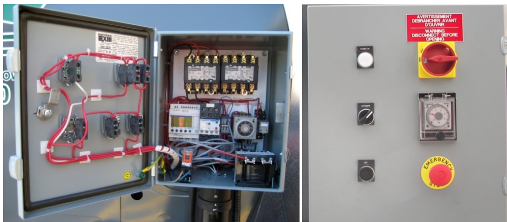
Figure 59: (a) Panneau de contrôle électrique ouvert seulement lorsque l'électricité est coupée et (b) barré lorsque l'alimentation électrique est allumée (photos Alexis Fortin).
