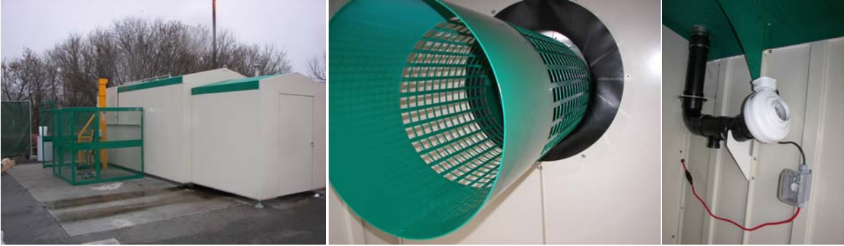
Figure 114: Le composteur modulaire sous abri de l'Université d'Ottawa est équipé (a) d'un lève-bac hydraulique, (b) d'un tamis et (c) d'un système de ventilation pour évacuer l'air sortant du composteur de sous l'abri (photos Alexis Fortin).
