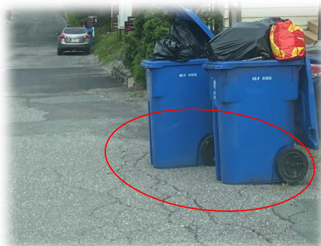
Photo 16 : bac sur la chaussée
